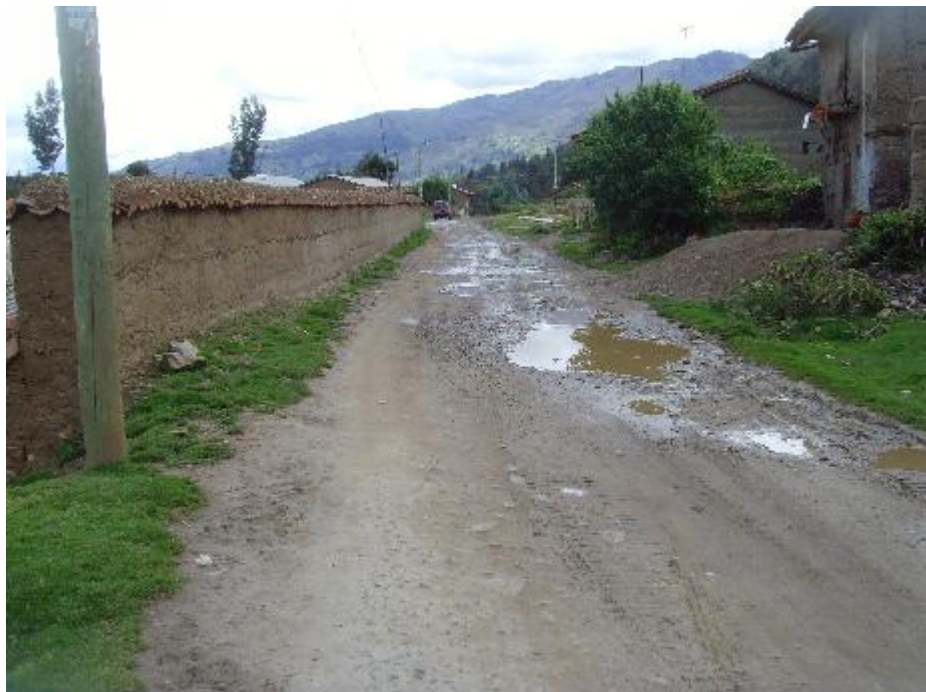
Foto N°04. -Se muestra la Vía completamente deteriorada por falta de un mantenimiento adecuado y una reposición de Base Granular a la altura de la Plaza de armas de Huamantanga.
