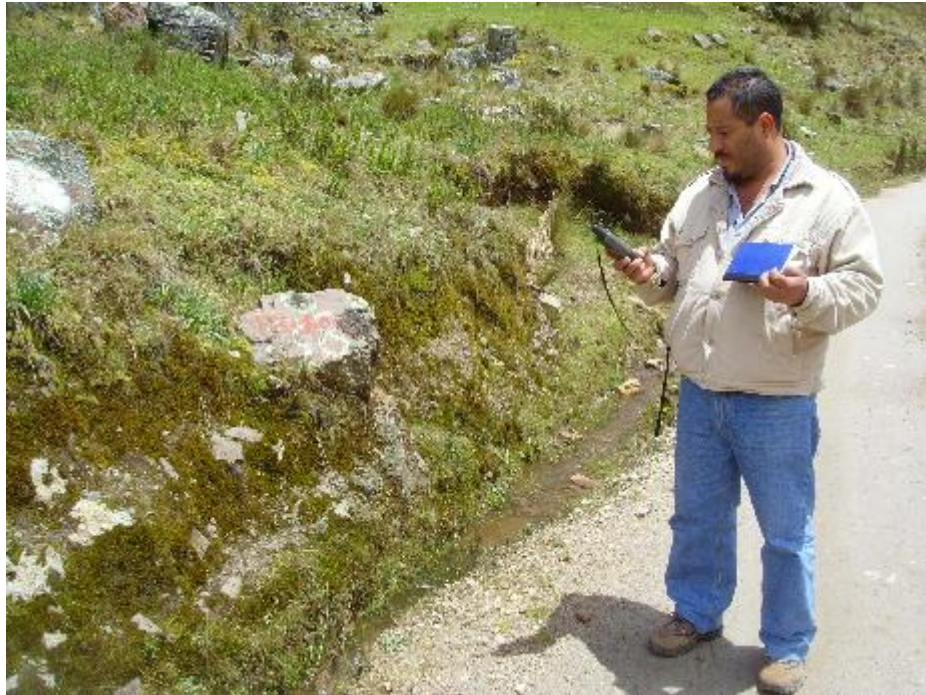
Foto N°01. -Se muestra parte del levantamiento Topográfico de la Carretera a la altura de Tashta KM 134+200 donde se aprecia la falta de limpieza de Cunetas.
