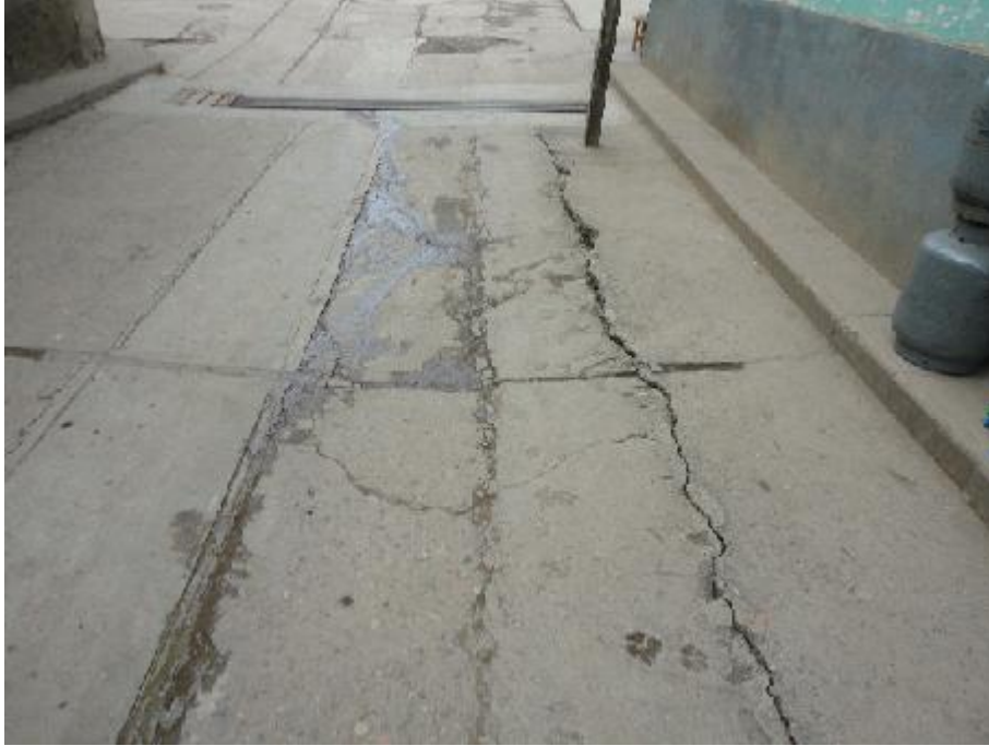
FOTO 01: Vista del Pavimento Rígido fracturado del Jr. Pedro Villon Cuadra 02, que genera filtraciones que pueden perjudicar a las viviendas aledañas edificadas de material recuperable.
