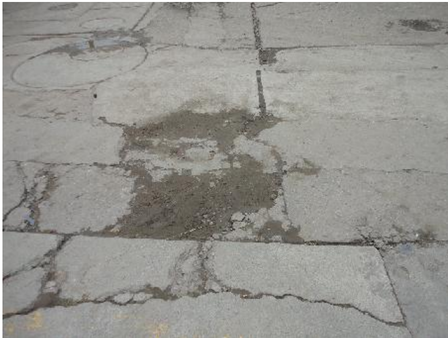
FOTO 02: La toma nos muestra fisuras múltiples en el pavimento, lo con las constantes precipitaciones pluviales puede ocasionar asentamientos que pueden ocasionar accidentes de tránsito.
