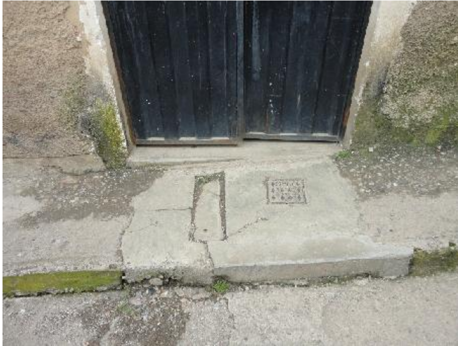
FOTO 03: En la toma se muestra las conexiones domiciliarias y veredas totalmente deterioradas.
