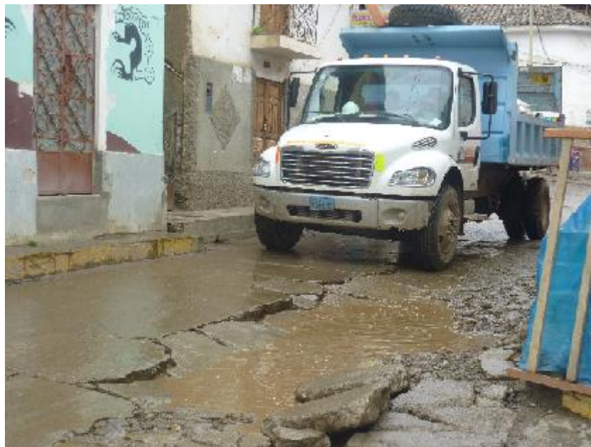
FOTO 02: Vista del Pavimento Rígido fracturado que puede generar accidentes vehiculares por el fuerte asentamiento debido al paso de tránsito pesado.
