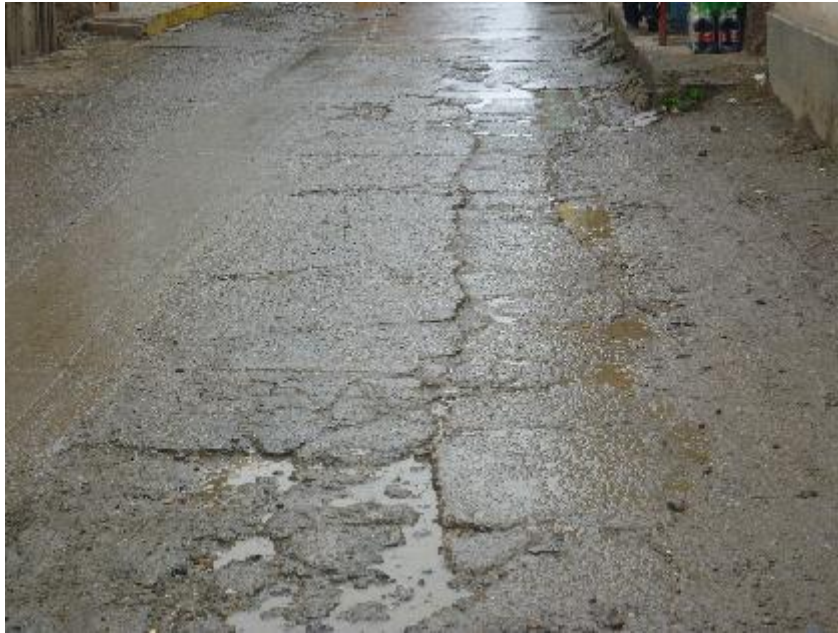
FOTO 03: Vista cercana en donde se aprecia las fisuras múltiples del pavimento rígido debido al paso del tiempo y constante tránsito vehicular así como presencia de precipitaciones pluviales.
