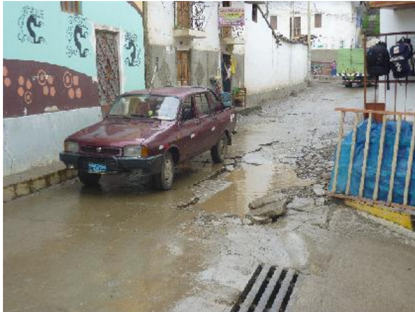
FOTO 01: Vista del Pavimento Rígido fracturado del Jr. Ramón Castilla Cuadra 05, que genera filtraciones que pueden perjudicar a las viviendas aledañas edificadas de material recuperable.
