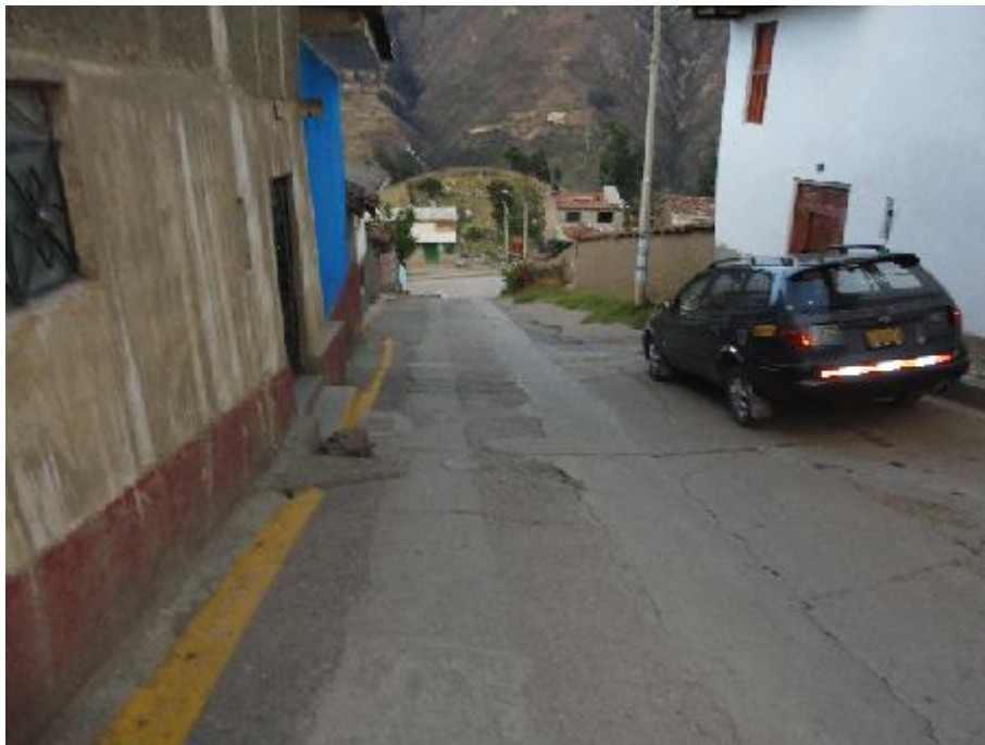
FOTO 02: La toma nos muestra fisuras múltiples en el pavimento, lo con las constantes precipitaciones pluviales puede ocasionar asentamientos que pueden ocasionar accidentes de tránsito.
