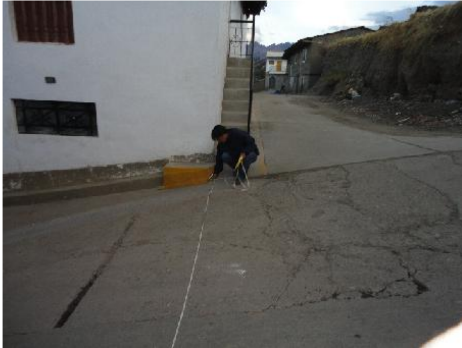
FOTO 03: En la toma se muestra el cruce del Jr. San Martín con el Jr. Túpac Amaru totalmente fracturado.
