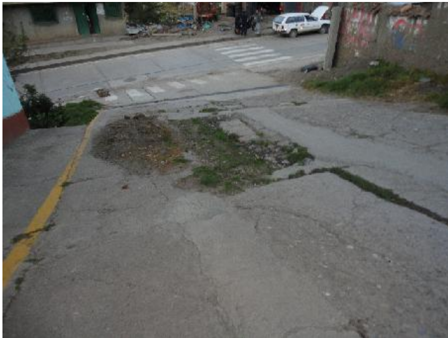
FOTO 04: Se muestra el área de trabajo y parte del pavimento rígido a reponer el cual se encuentra totalmente fracturado, se muestra además al lado izquierdo por donde cruza la tubería pvc de diámetro de 2”.
