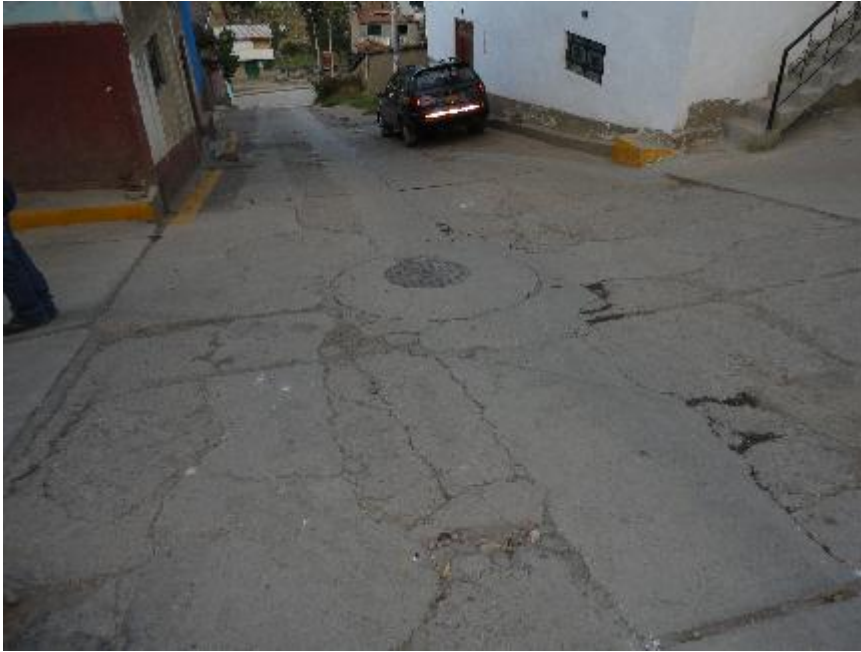
FOTO 01: Vista del Pavimento Rígido fracturado del Jr. San Martín Cuadra 01, que genera filtraciones que pueden perjudicar a las viviendas aledañas edificadas de material recuperable.
